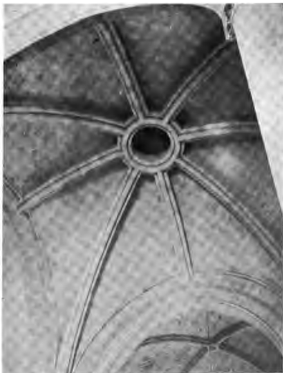
Fig. 136. — Coupole nervée du xiv e siècle. Transept de l'église de Nantilly à Saumur. Remplissages appareillés suivant les parallèles de la sphère.
